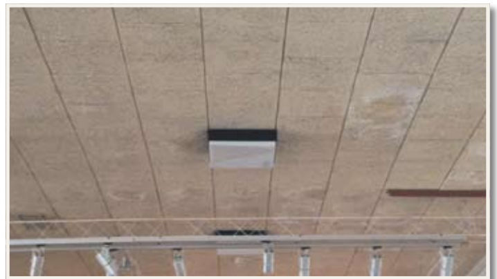
Feuchtigkeitsflecken auf der Decke sind nicht das einzige Indiz für erforderliche Sanierungsmaßnahmen für die Musikhalle Wilfersdorf.
