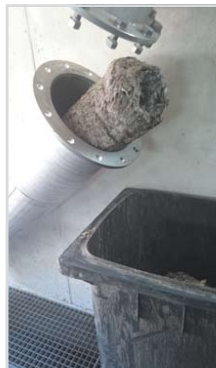
Verstopfung des Kläranlagerechens durch „Vermüllung“
