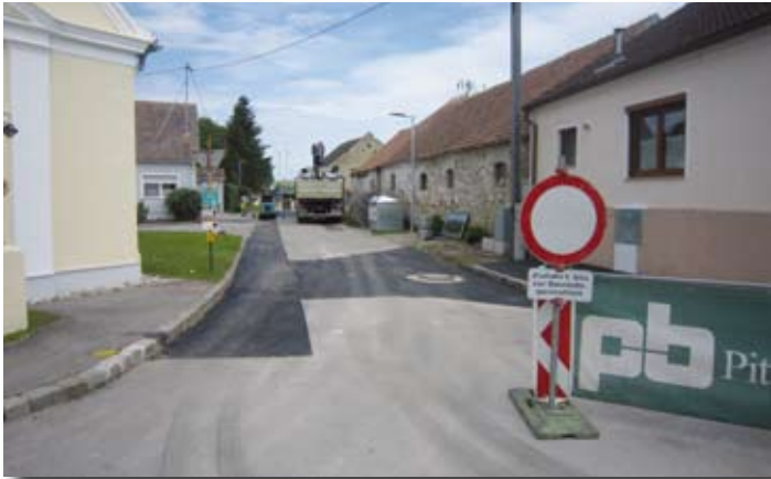
Die im Dezember 2019 begonnenen Kanalbauarbeiten konnten im Juni dieses Jahres endlich abgeschlossen werden. Foto: © Marktgemeinde Wilfersdorf
